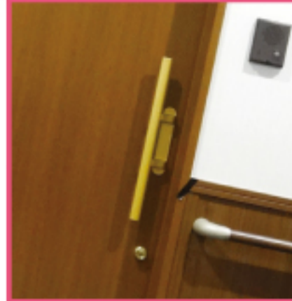
緊急通報装置
